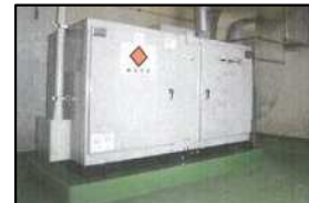
荷さばき所における非常用電源の整備
