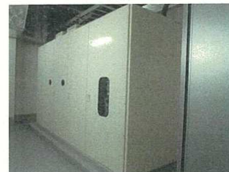
電源施設の浸水対策 (2階に設置)
